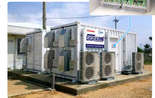
収納コンテナ外観 (手前コンテナに蓄電池収納)
