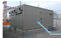
石津川変電所
